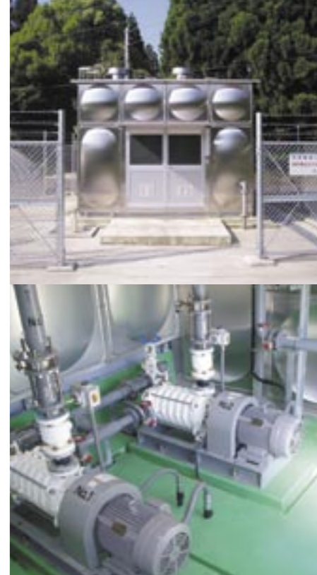
▲水道水を供給するポンプ施設 (写真は観音ポンプ場)。
